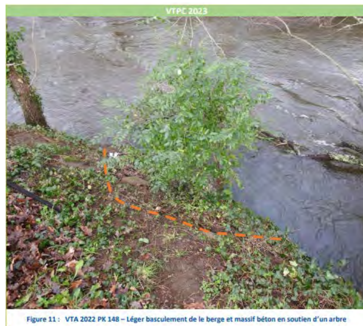
Figure 11 : VTA 2022 PK 148 – Léger basculement de la berge et massif béton en soutien d'un arbre
