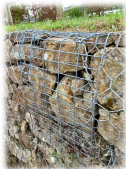
Reprise du maillage d'un gabion sur le SE de l'Hippodrome
